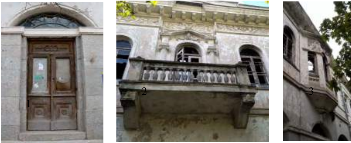
Рис. 5. Деталі фасаду по вул. Театральна, 10: 1. – ліві входні двері (автентичні); 2. - балкон ; 3. - еркер; (фото автора)
