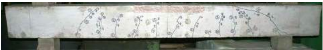
Рис. 6. Утворення тріщин у пошкодженій балці
